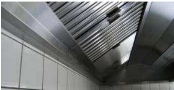
Abb. 2: Dunstabzugshaube mit flamm-durchschlags-sicheren Aerosolabscheidern (Abb. Tale-Yazdi)
