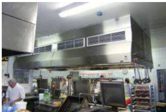
Dunstabzugshaube mit integrierter Wärmerückgewinnung
